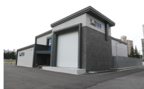
한전 김제변전소 FR용 (규모 : 48MW/12MWh)
