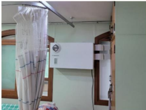
150WC1 벽걸이형 9대 설치
