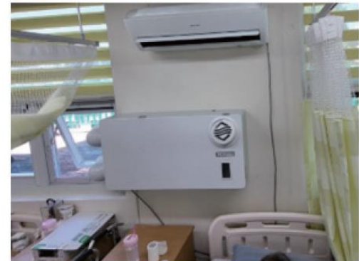
150WC1 벽걸이형 11대 설치
