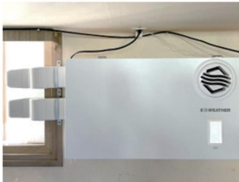
150WC1 벽걸이형 10대 설치
