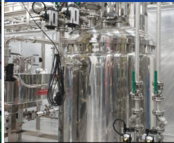
스토리지 탱크 (Storage Tank)
